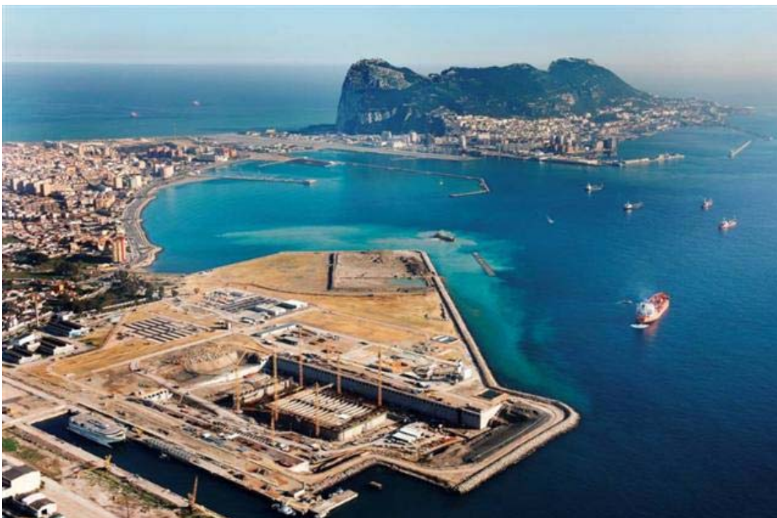
Impianto di rigassificazione dell'Alto Adriatico - Maggio 2005 - Iniziano i lavori di costruzione della struttura in cemento armato (GBS) nel bacino di Campamento, ad Algeciras, in Spagna
